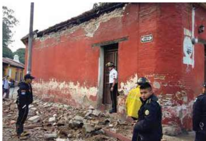
Figura 3. Vivienda dañada Foto: Bomberos Voluntarios
