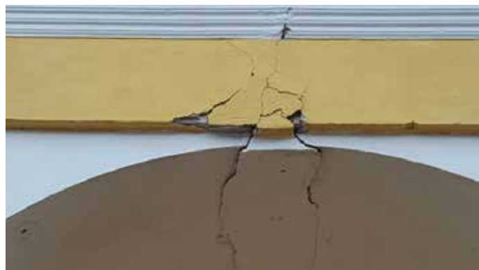
Figura 1. Daños en Arco de la Torre del Reloj de Ciudad Vieja, Sacatepéquez Foto: Julio Sicán
